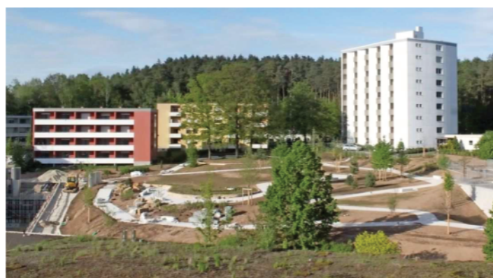
Die bestehenden Gebäude auf dem Areal hinter dem Klinikum sollen abgerissen werden, um für ein neues Wohnviertel Platz zu schaffen.
